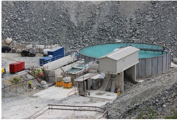
Čistička odpadových vôd
