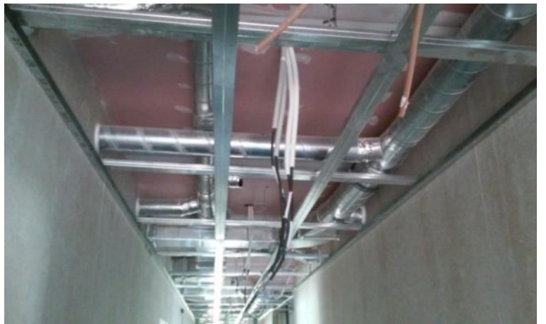
7. Vedenie potrubí v podhl'adoch
